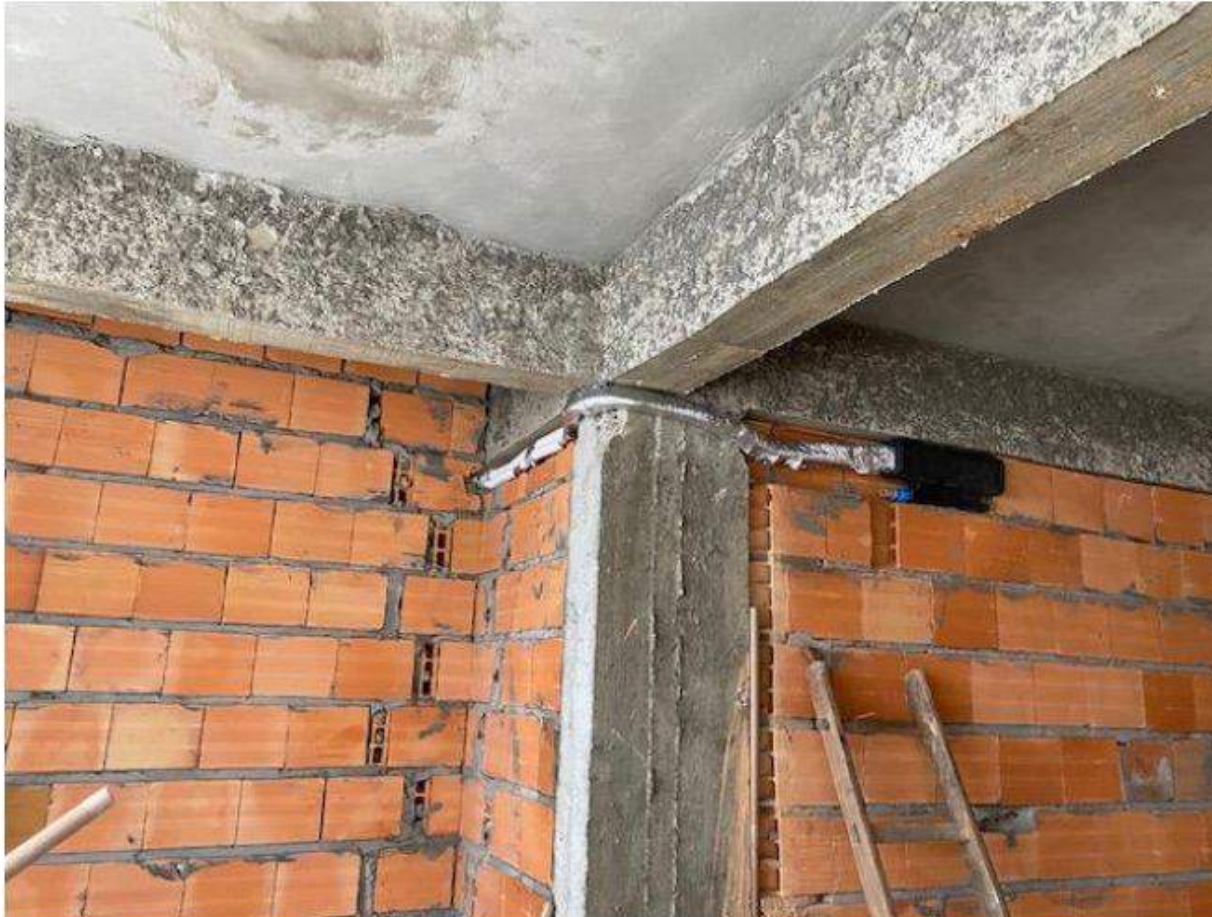
Foto 01 – Infraestrutura de ar condicionado não prevista no orçamento
