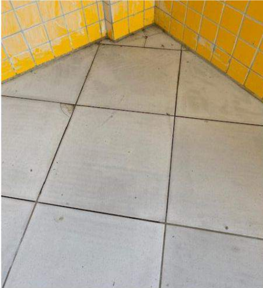
piso de revestimento trincado e fugas/rejuntas a executar
