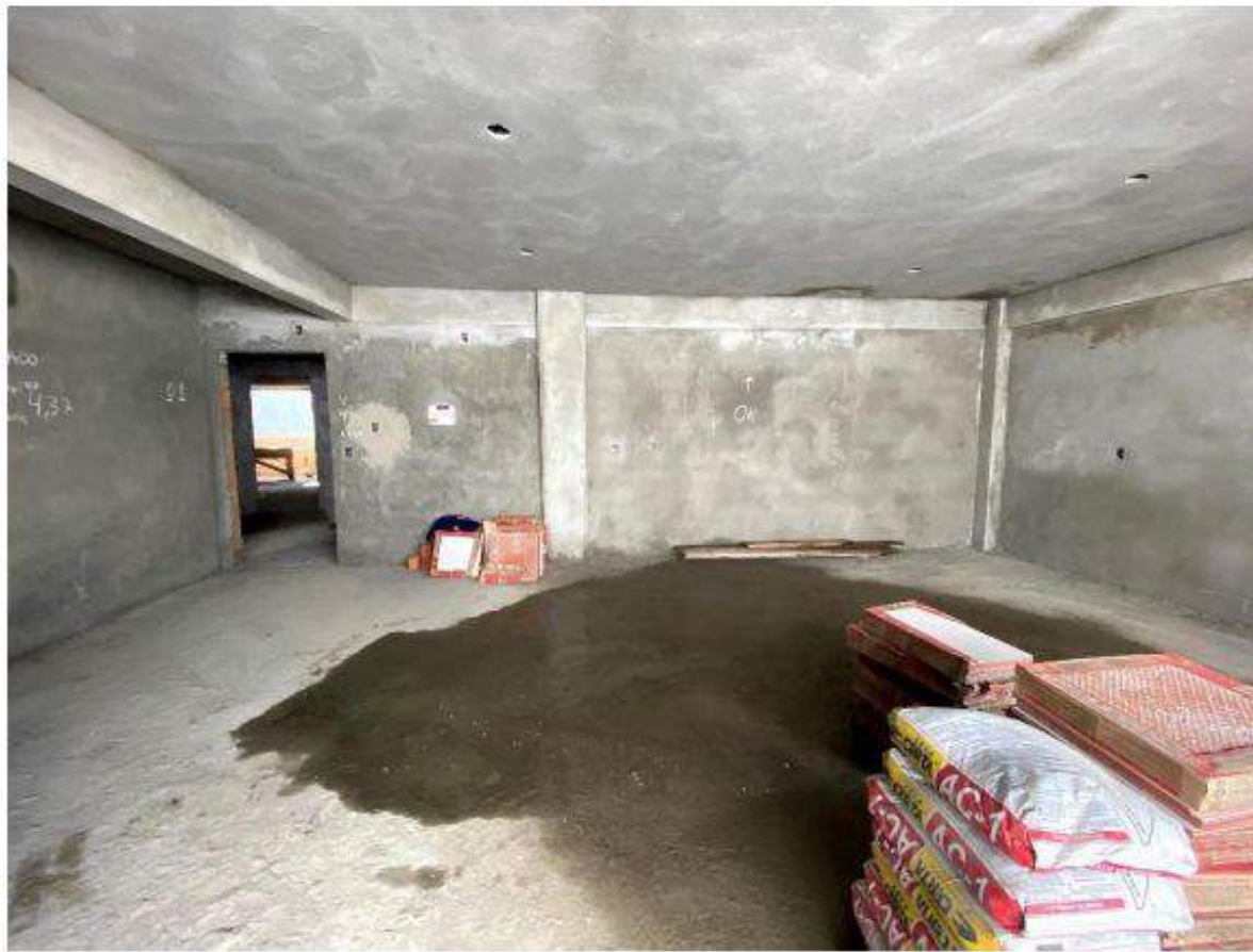
- Sala de aula – reboco teto e paredes/argamassa e cerâmica estocada em área molhada.
