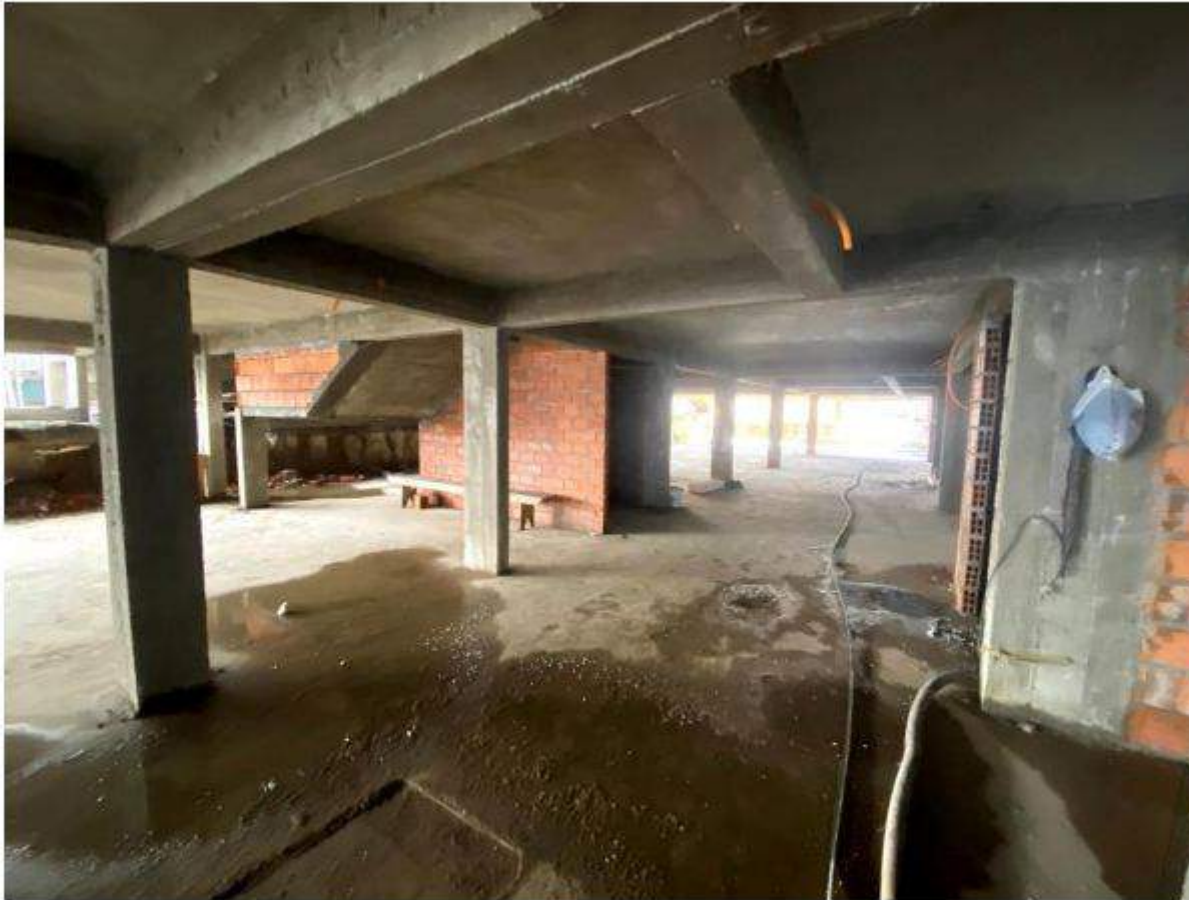
Acúmulo de água no centro do pavimento/tetos rebocados /pilares, vigas e paredes não rebocadas.
