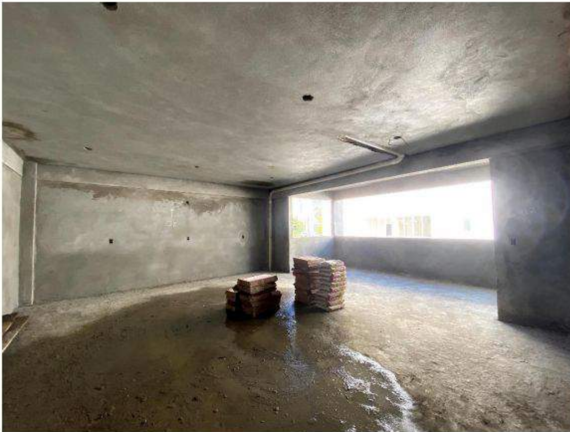
Sala de aula – reboco teto e paredes/argamassa e cerâmica estocada em área molhada / rasgo no teto de tubulação drenagem do terraço (não previsto em projeto).
