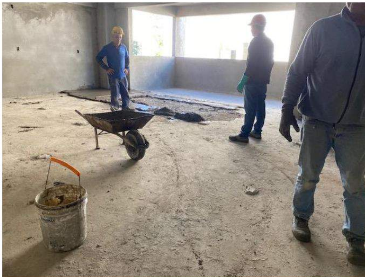
Nivelamento do contrapiso pra respeitar o projeto arquitetônico – 2,0cm de desnível entre sala de aula e solário
