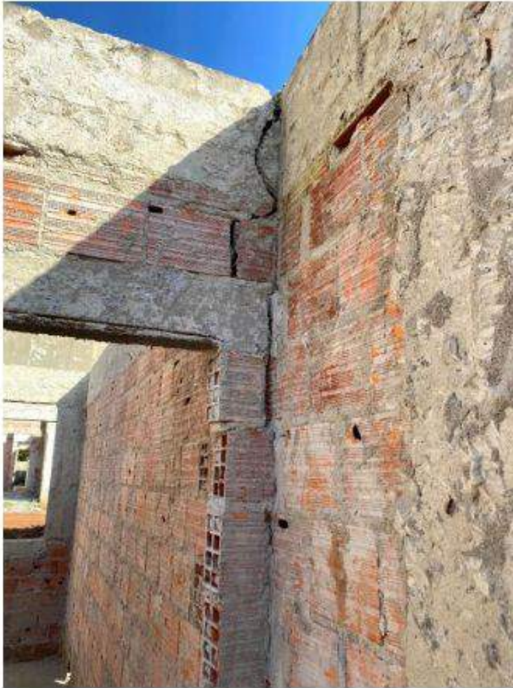
Descolamento da estrutura das vigas e da alvenaria
